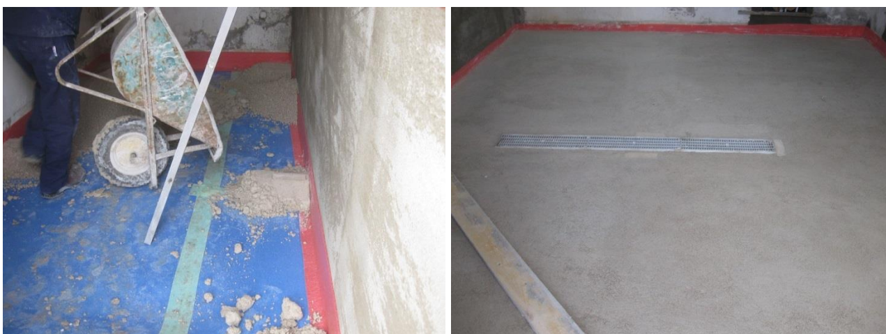
Figura 3. Realizzazione di un massetto in anidrite a consistenza semi-umida, formulato a partire dall'utilizzo di sabbie di riciclo derivanti da processi di demolizione e vagliatura eseguiti direttamente in cantiere.
